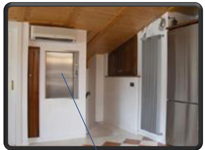
Vue de face du monte-charge
