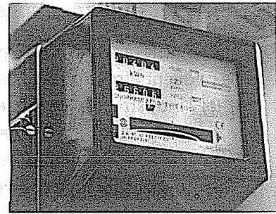
Compteur électromécanique Landis&Gyr
