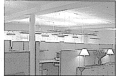
Flux de luminaires direct et indirect
