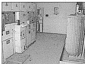
Intérieur d'un poste HTA/BT
